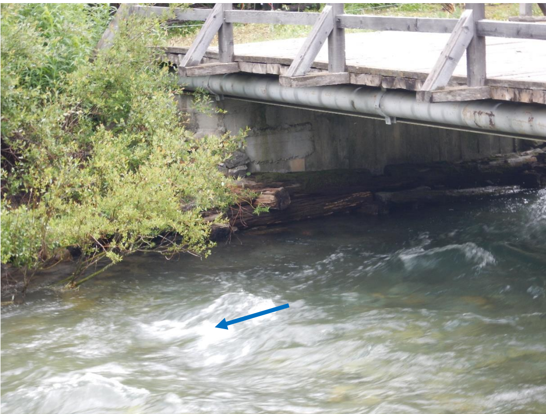
Figure 28 : Conduite BT ENEDIS en encorbellement côté aval du pont de Ville Basse
