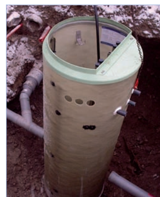
Poste de relèvement au Chabas
